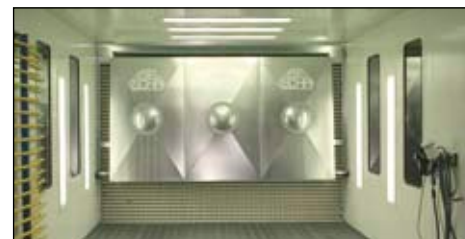
Cabine de vernis avec lampes encastrables
