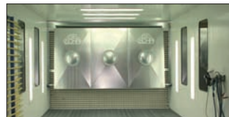
Lackierkabine mit Einbauleuchten
