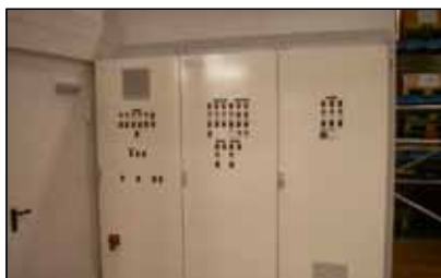
ЧПУ-управление и энергосберегающая автоматика
