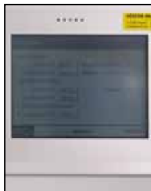
Современный пульт управления с сенсорным экраном (Touch-Screen)
